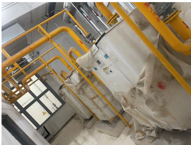
图 4.1-1 锅炉现场照片
