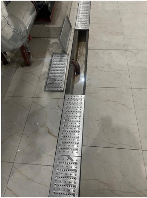
图 4.1-2 锅炉房内污水槽
