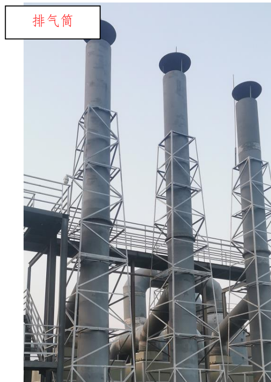
图 2-6 废气治理设施现场照片
