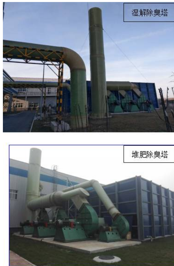
图 4-2 废气治理设施现场照片
