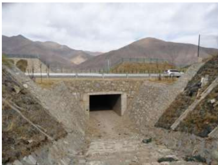
图 5.3-1 公路为牛通行修建的专用涵洞
