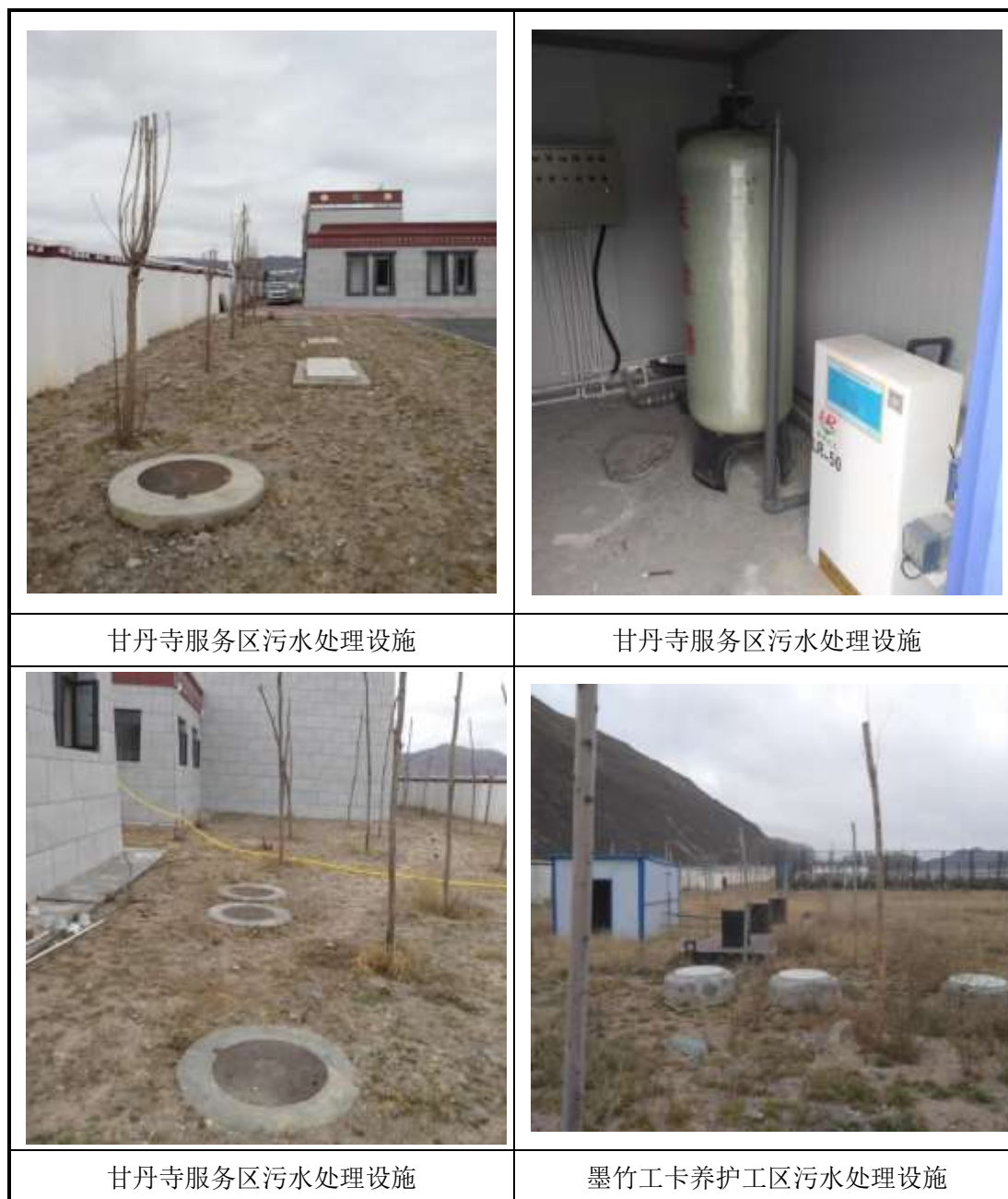
图 6.3-2 服务区和养护工区污水处理设施照片
