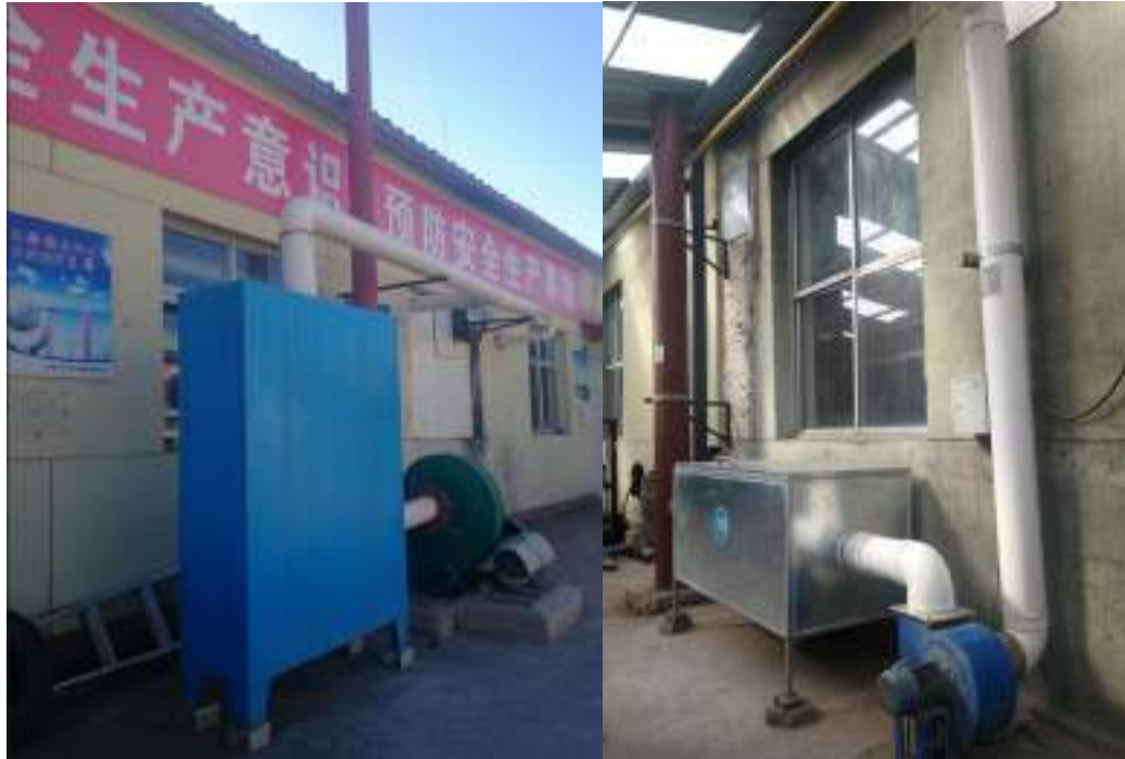
图 2-5 活性炭装置和排气筒现场照片
